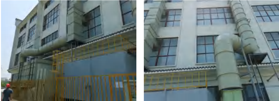
生物处理车间废气处理装置及 DA006 排气筒
