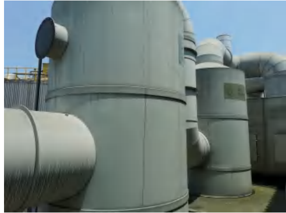
预处理车间废气处理装置
