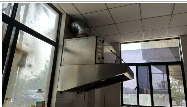
图 4-3 食堂油烟处理装置
