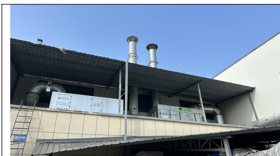
图 4-1 涂装废气（左）处理装置
