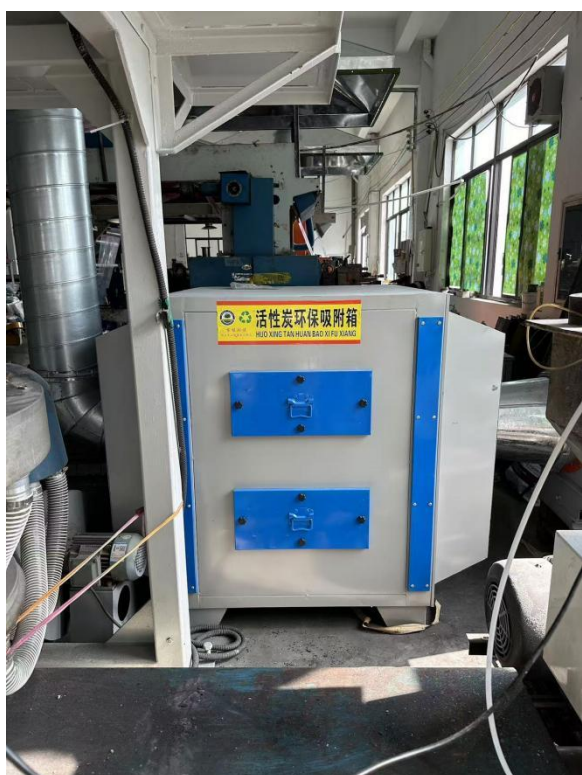
图 3-6 1#厂房 3 层车间活性炭吸附装置实拍图
