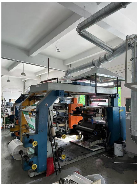
图 3-5 1#厂房 3 层车间印刷机收集装置实拍图
