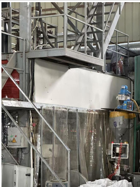
图 3-1 2#厂房 1 层车间吹膜机收集装置实拍图
