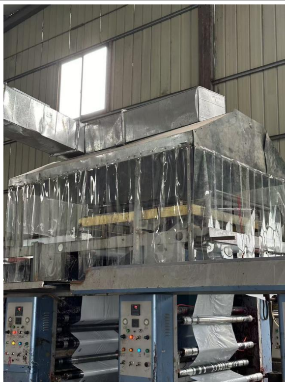
图 3-2 2#厂房 1 层车间印刷机收集装置实拍图
