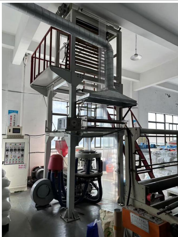
图 3-4 1#厂房 3 层车间吹膜机收集装置实拍图
