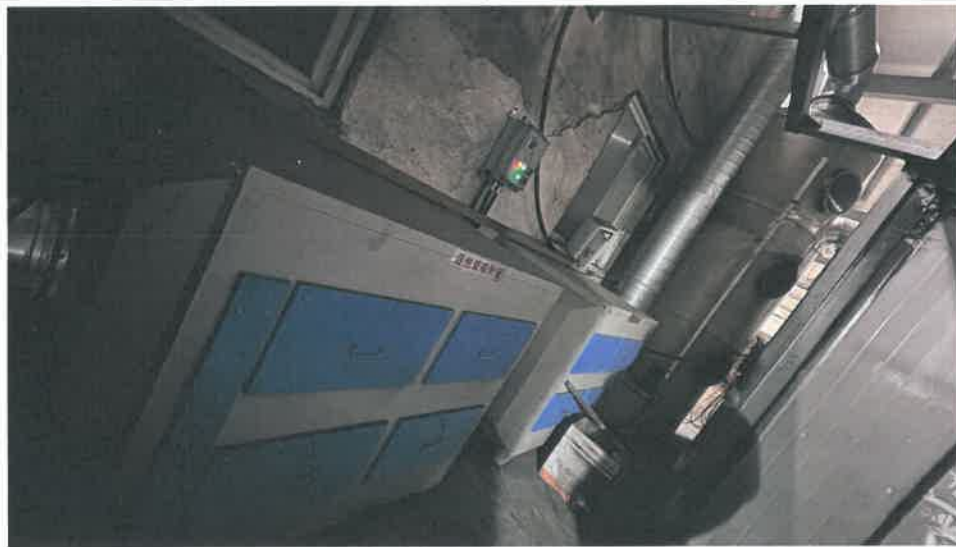
图 4-3 固化废气处理装置
