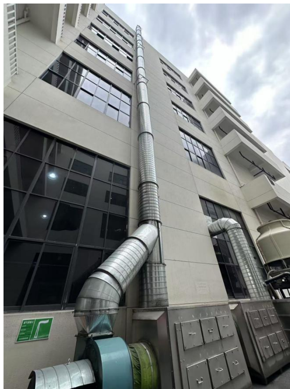
图 3-2 干式过滤+二级活性炭吸附装置及排气筒 DA001 实拍图
