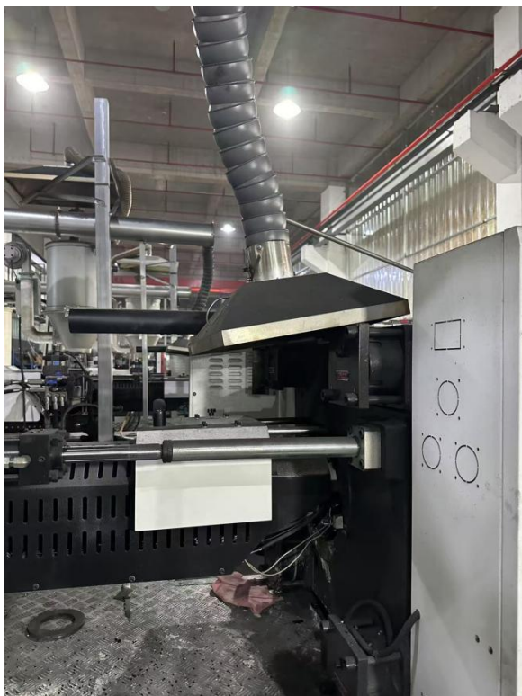
图 3-1 注塑机出口集气罩实拍图
