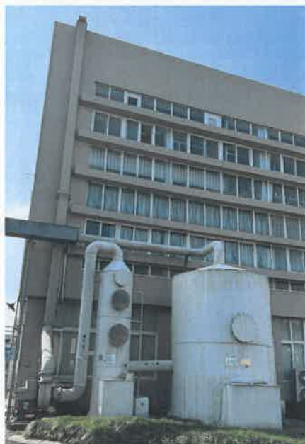
图 4-5 污水站废气处理装置
