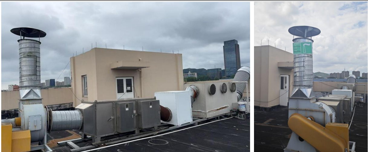
图 3-1 挥发废气收集与处理装置、排气筒
