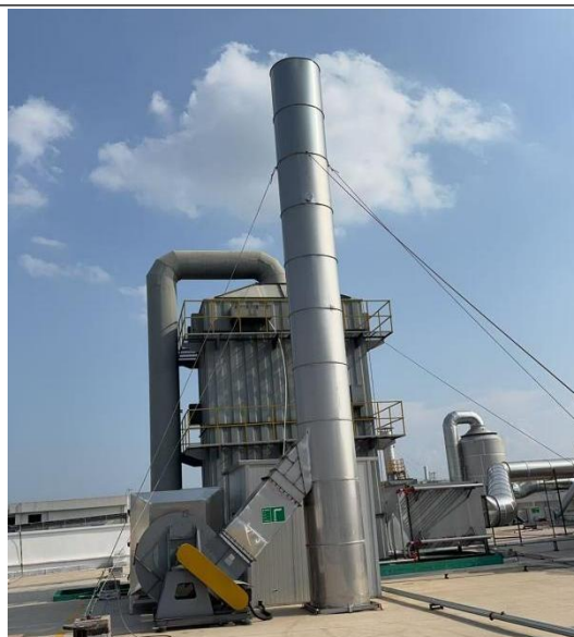
图 3-1 开布、上浆、烘干废气收集与处理装置、排气筒 DA001
