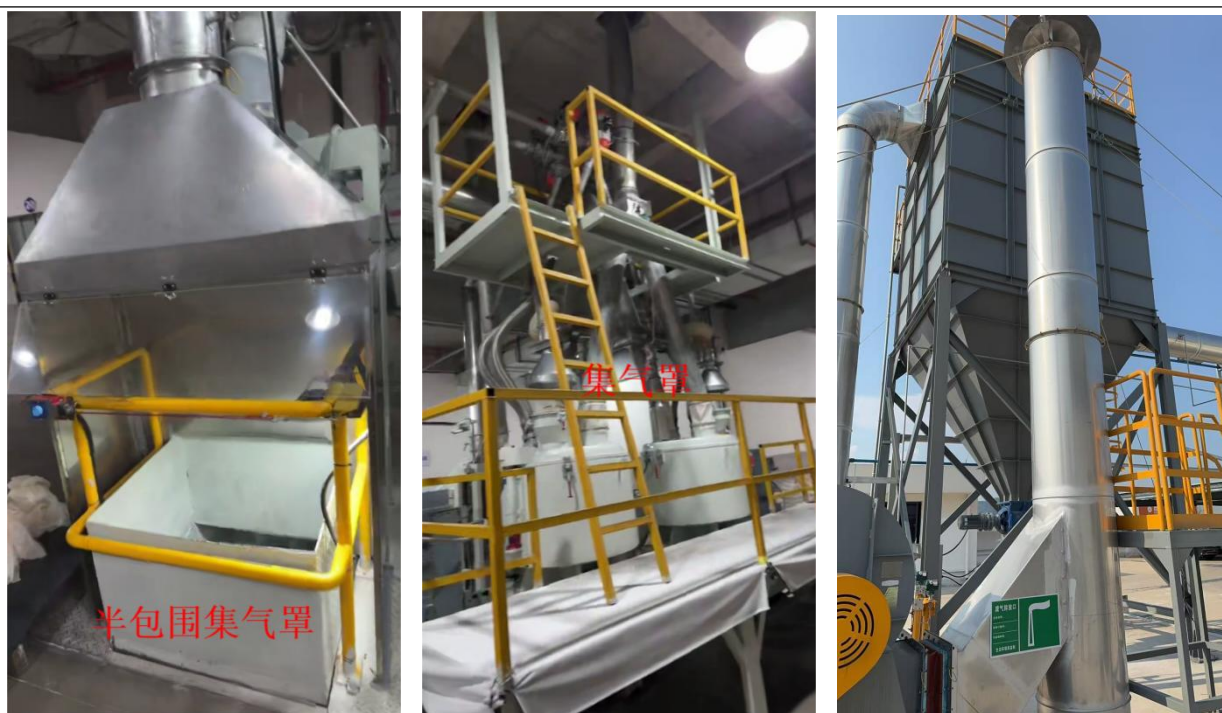
图 3-2.2 2#厂房投料粉尘收集与处理装置、排气筒 DA003
