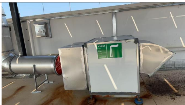
图 3-7 燃烧废气排气筒 DA011、DA012、DA013
