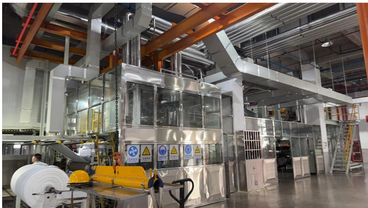
图 3-3.1 密炼开炼压延机组废气收集装置
