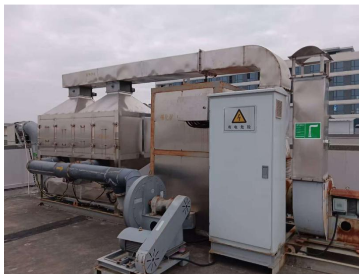
图 3-1 印刷废气处理装置、排气筒
