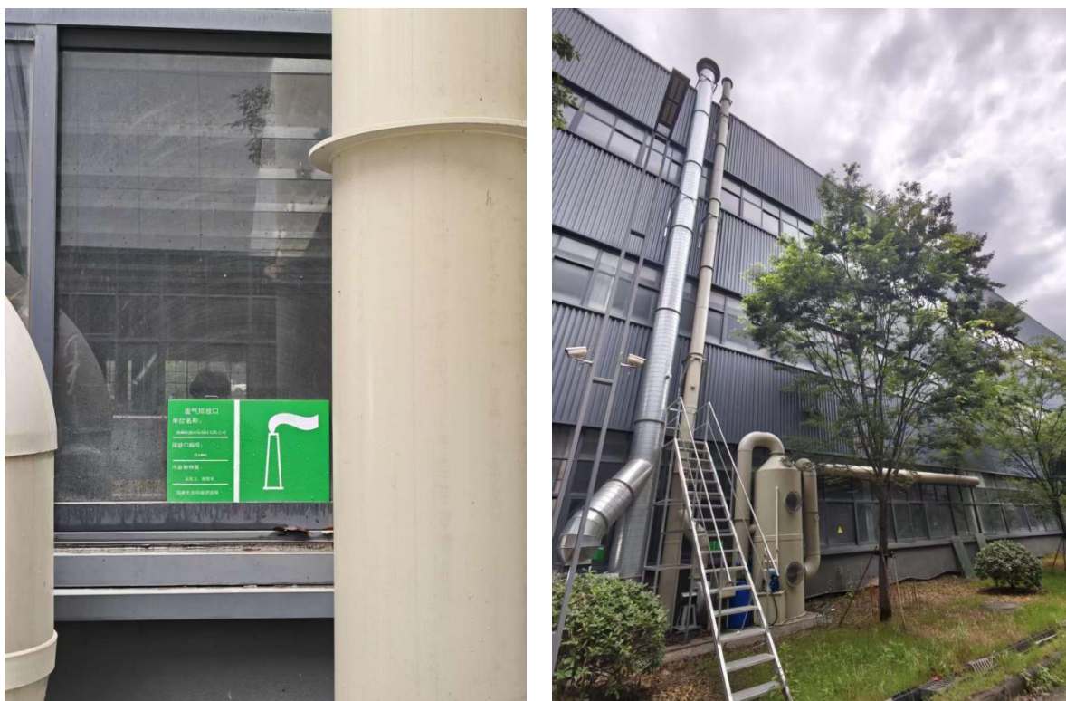
图 3-2 酸雾废气集气方式及排气筒 DA002 实拍图
