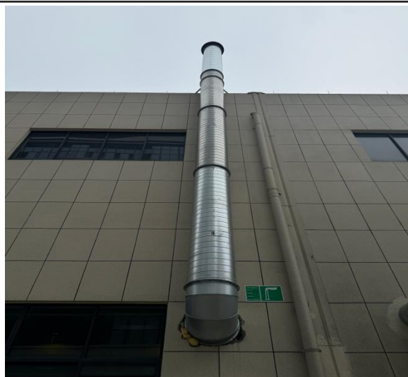
图 3-3 抛光粉尘收集+处理设施+排气筒（DA003）实拍图
